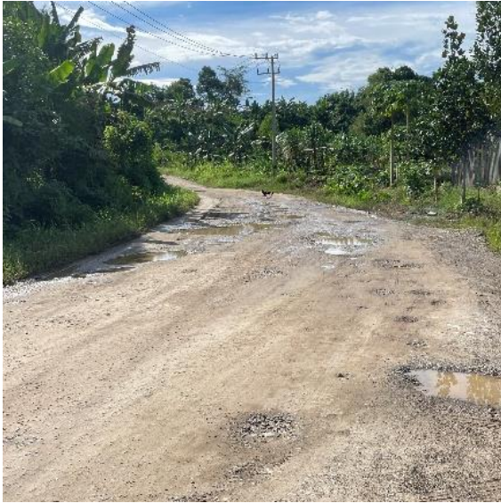
Gambar 2. Kerusakan jalan akibat genangan air Sumber: Dokumentasi Pribadi 2025
