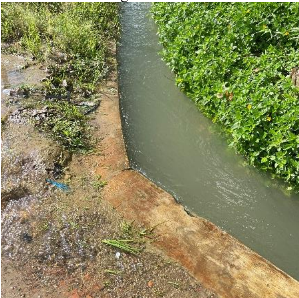
Gambar 3. Kondisi drainase yang tidak berfungsi optimal Sumber: Dokumentasi Pribadi 2025
