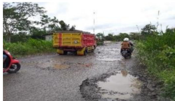
Gambar 1. Perlintasan Menuju Area Penambangan Pasir Yang Rusak
